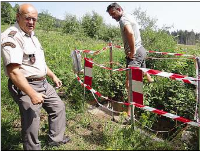
DANGER. Julien Peny (à gauche), accompagné des gardes forestiers et du policier municipal, constatent que le lieu est bien sécurisé. Tous souhaitent que, rapidement, ce trou soit recouvert d'une plaque, afin d'éviter un accident toujours possible.
